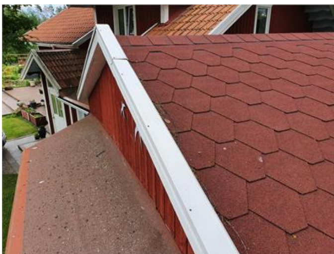
Tak: Plåtar saknas delvis i anslutning mellan tak/fasad.
