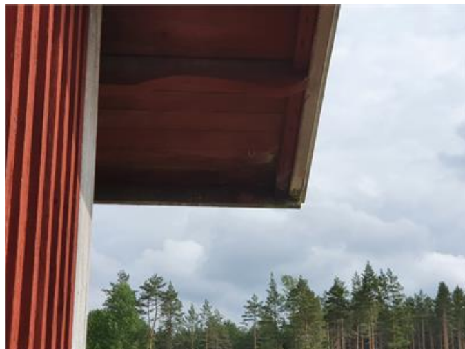
Tak: Fuktfläckar och rötskador förekommer i takfot.
